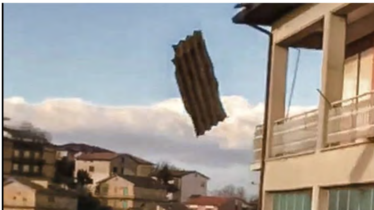
Figura 70: Fermo: una grande lastra di eternit vola via dal tetto di una palazzina - (ilrestodelcarlino.it - fermo)
